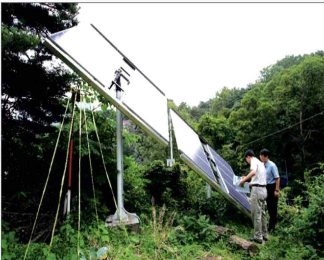
부암동 에너지대안센터에 설치된 시민발전1호 태양광발전소
